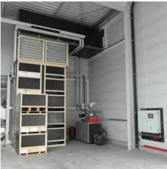
Overzicht van drooginstallatie voor twee secties met centrale verwarming.
