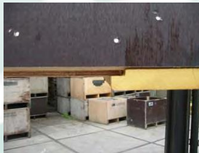
Verskil in dikte van het multiplex en de hardhouten plank.
