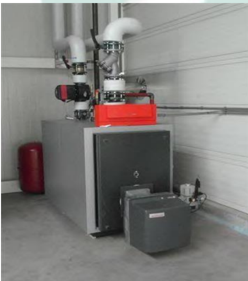
Voorbeeld van een boiler voor de centrale verwarming van twee secties.
